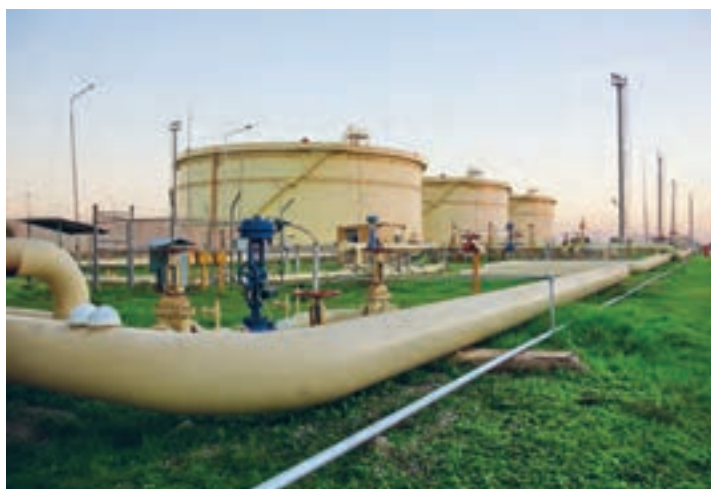
شکل ۲۱- نمایی از خطوط انتقال سوخت
