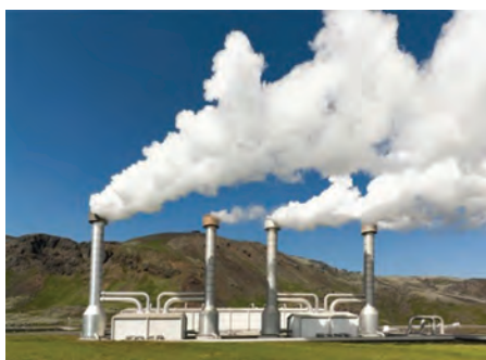
شکل ۱۱-۶- نیروگاه زمین گرمایی مشکین شهر- اردبیل
